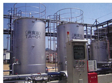
●廃食油貯蔵タンク
