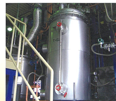
●前処理タンク
